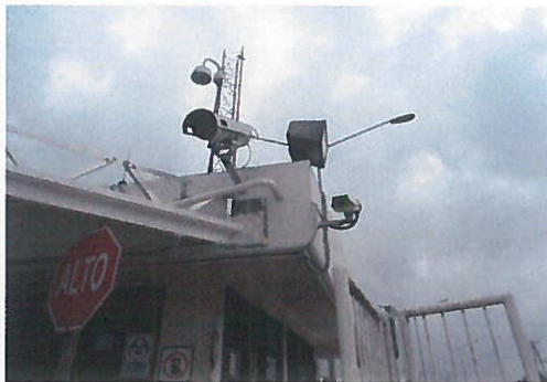
SE CONCLUYO LA INSTALACION DE CAMARAS DOMO
