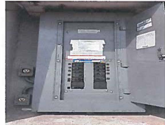
balanceo de cargas en tablero
