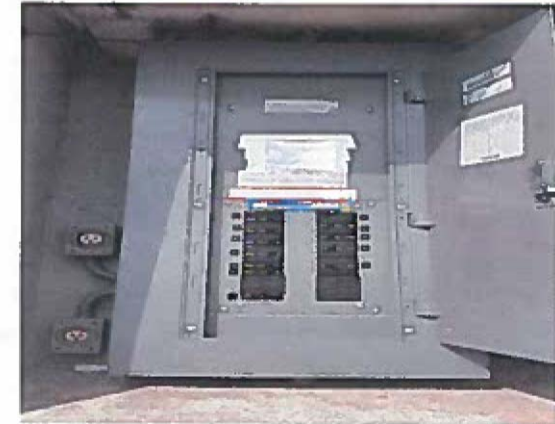
balanceo de cargas en tablero
