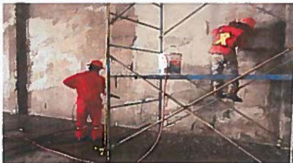
lavado de pared en eje A
