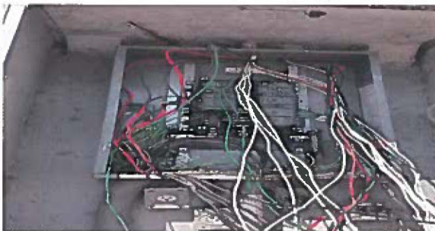
cableado de tablero de distribucion
