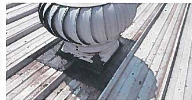
sellado con plastc cement en extractores
