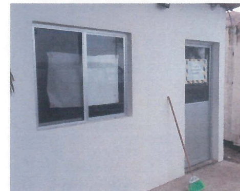
VISTA DE FACHADA DE CASETA DE CONTROL Y VIGILANCIA CON PUERTA Y VENTANA INSTALADAS.
