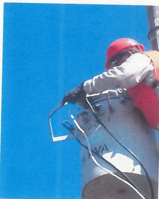
PRUEBAS DE AISLAMIENTO A DEVANADOS EN ALTA Y BAJA TENSION A TIERRA.
