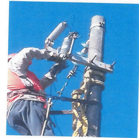
PORTAFUSIBLE Y CORTACIRCUITO INSTALADOS EN LINEA AEREA EN MEDIA TENSION.
