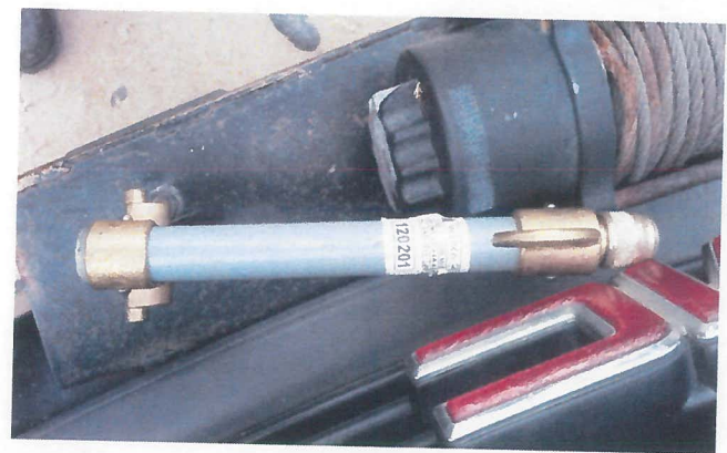
PORTAFUSIBLE CANASTILLA DE 13.2 KV EN CORTACIRCUITO EXISTENTE
