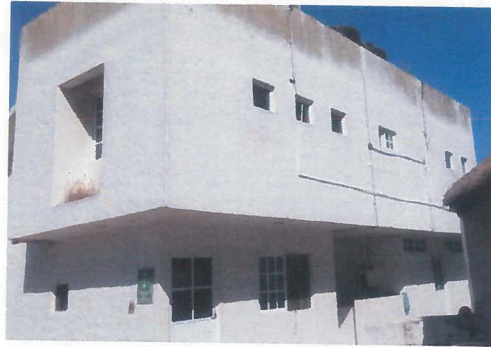
OTRA VISTA DEL DETERIORO DE LA PINTURA EN CASA DE LA PALAPA.
