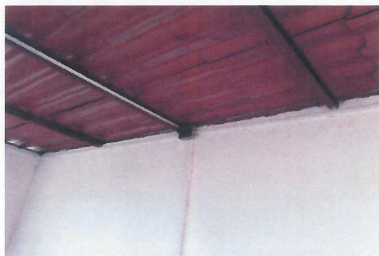
INSTALACIONES ELECTRICAS EN CASETA DE VIGILANCIA.
