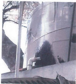
INSTALACIONES HIDRAULICAS PARA EL FUNCIONAMIENTO DEL TANQUE ROTOPLAS
