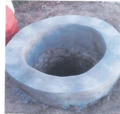
FOSA SEPTICA EN BUENAS CONDICIONES.
