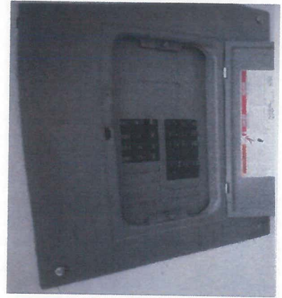
SUSTITUCION DE TABLERO HE INTERRUPTORES TERMOMAGNETICOS.
