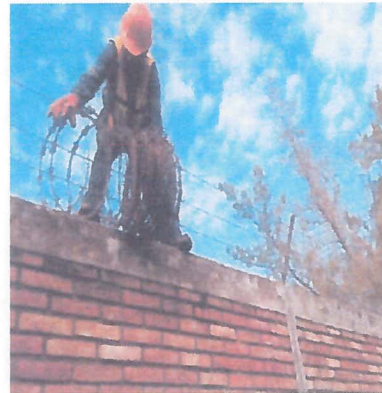
RETIRO DE CONCERTINA DE BARDA PERIMETRAL EN MAL ESTADO
