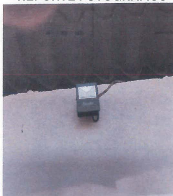
REFLECTORES INSTALADOS EN CASETA DE VIGILANCIA EN PALAPA.
