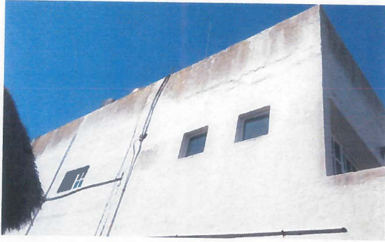
VISTA DE LA PINTURA DE LA CASA EN LA PALAPA EN MAL ESTADO
