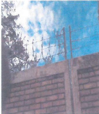
CONCERTINA EN BARDA PERIMETRAL EN MAL ESTADO
