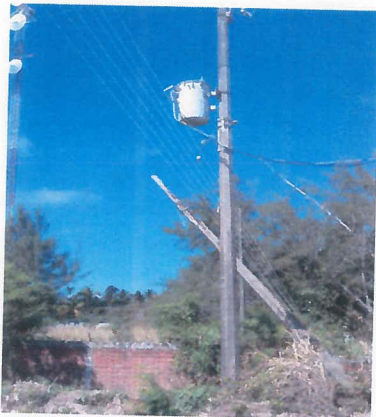
VISTA DEL TRANSFORMADOR.
