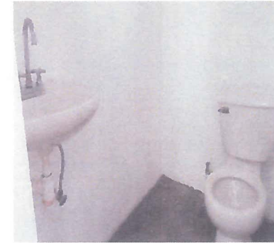
LAVABO Y WC INSTALADOS EN BAÑO
