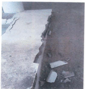
DESCANSOS DE LA PALAPA EN MAL ESTADO
