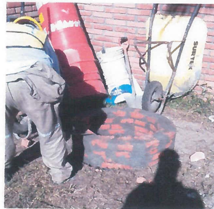
ENRASE A FOSA SEPTICA PARA EVITAR QUE SEA TAPADA POR ARENA Y MALEZA.
