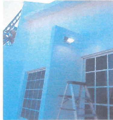
LUMINARIAS TIPO LED INSTALADAS CORRECTAMENTE
