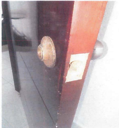
ESTADO EN EL QUE SE ENCUENTRA LA CERRADURA DE LA PUERTA
