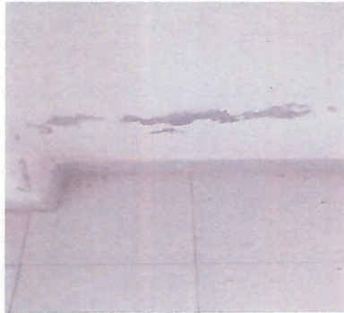
PINTURA DE INTERIORES DE LAS RECAMARAS EN MAL ESTADO.
