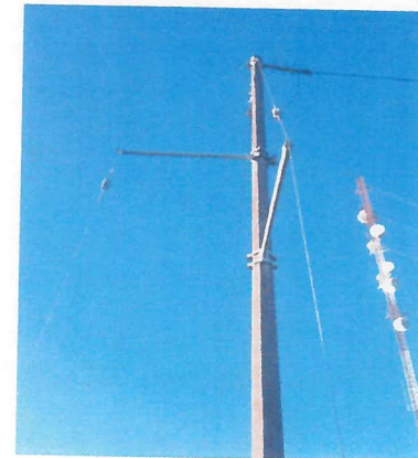
OTRA VISTA DE RETENIDA EN FUNCIONAMIENTO.
