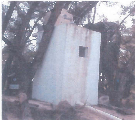
VISTA TRASERA DEL BAÑO DEL ESTADO EN EL QUE SE ENCUENTRA LA PINTURA
