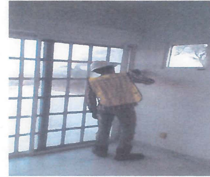
APLICACION DE PINTURA EN INTERIORES DE LAS RECAMARAS DE LA CASA DE LA PALAPA.
