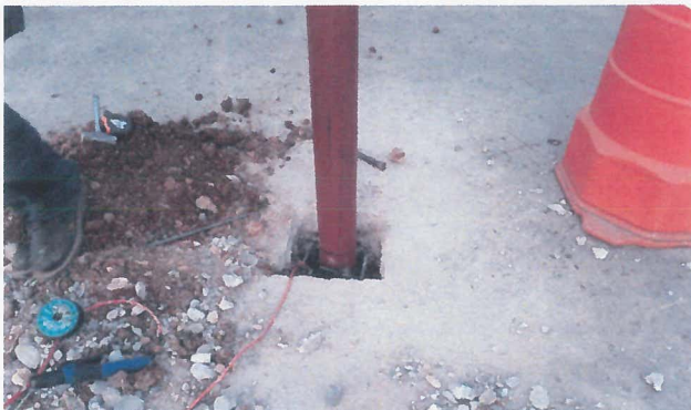
POSTES CENTRALES COLOCADOS CON ACERO DE REFUERZO LISTOS PARA VACIADO DE CONCRETO.
