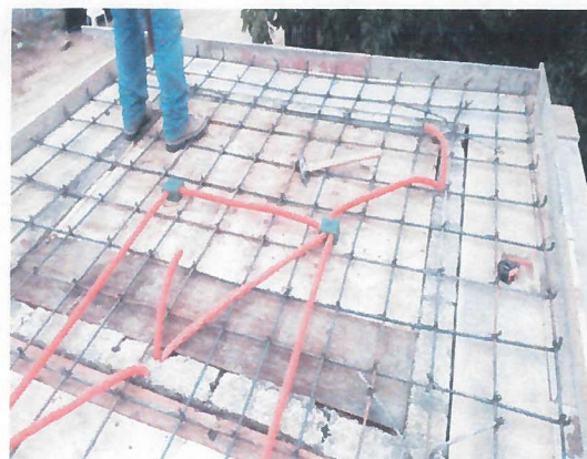
SALIDA ELECTRICA PARA LUMINARIAS CIRCUITO L-1 Y L-2
