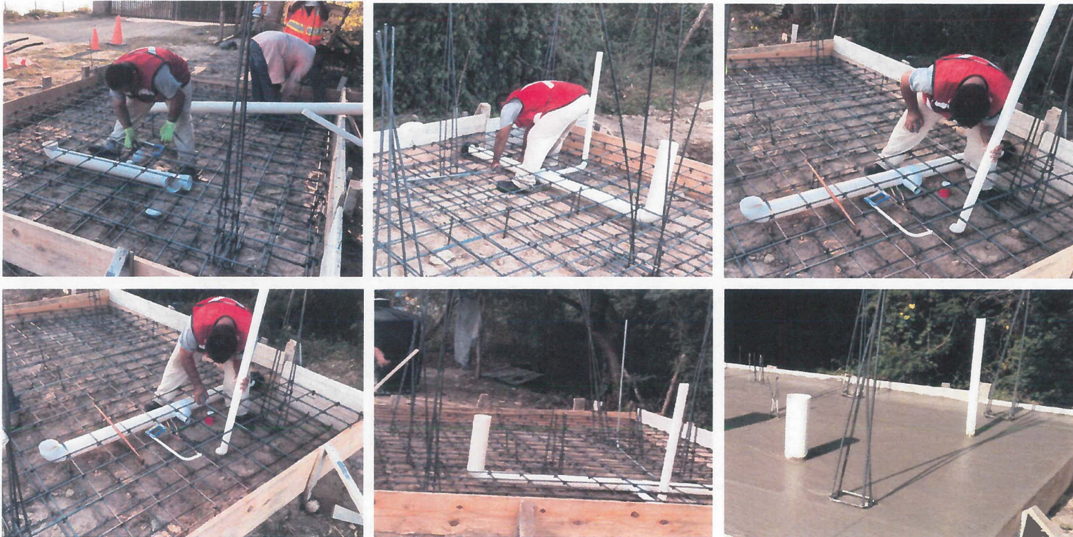
SALIDA SANITARIA PARA LAVABO, W.C.Y COLADERA A BASE DE TUBO DE 2" Y 4" PULG. DE DIÁMETRO
