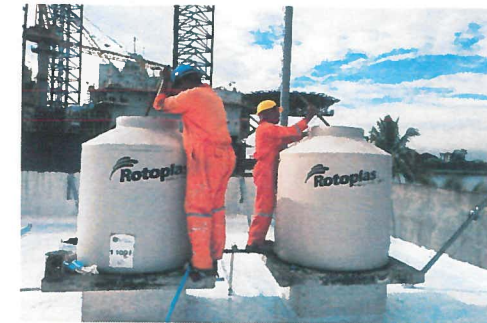
Limpieza de tinacos rotoplas con capacidad de 1,000.00 litros aproximadamente existentes en area de azotea.
